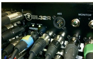
Obsługa samego „miksera” sprowadza się w zasadzie tylko do właściwego podłączenia kabli i załączenia zasilania.
